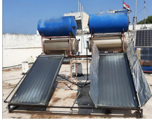
الشكل (٥) المجمعات الشمسية المختبرة (اليمين: مجمع مع عواكس، اليسار: مجمع بدون عواكس للمقارنة).
